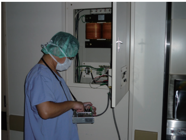
絶縁監視装置の動作試験
